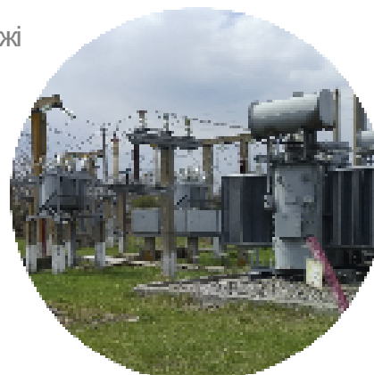
Дистанційне керування з підстанції
