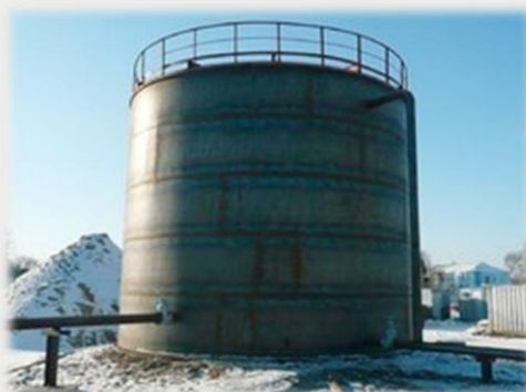
Бак термоакумулятор 100-200 м3
